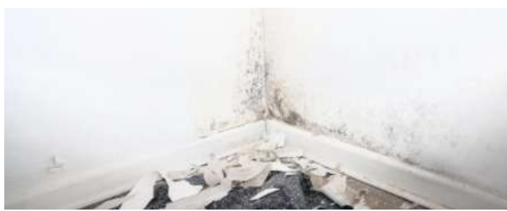
Schimmelbefall durch Kältebrücken.
