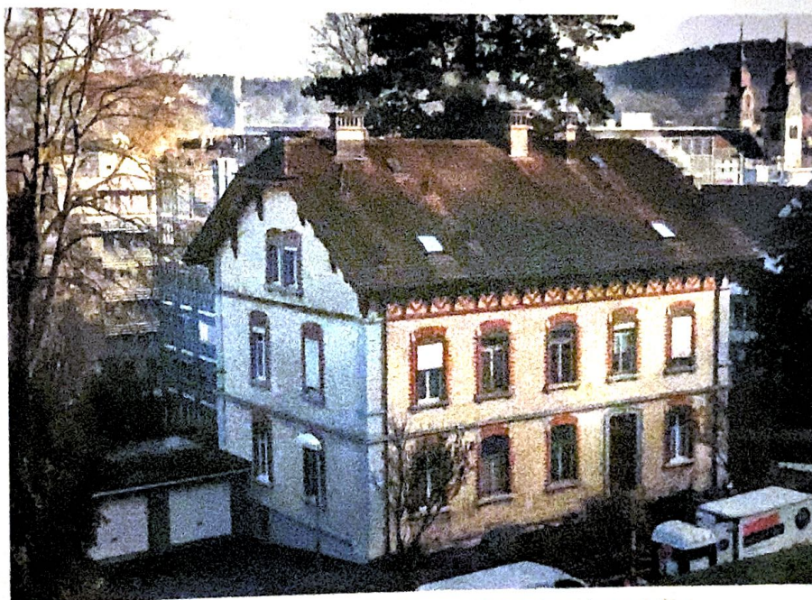
Feuchteschäden relativieren den objektiven Wert einer Immobilie.
