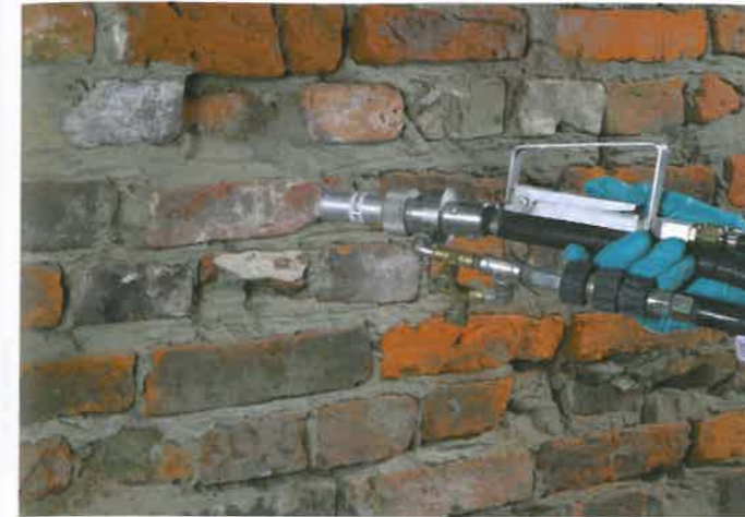
Untergrundvorbereitung vor der eigentlichen Bauwerksabdichtung: Alte Putze und Anstriche sind generell bis 80 Zentimeter über der Schadenszone zu entfernen und geschädigte Fugen 2 Zentimeter tief auszukratzen.
