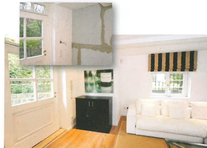
Die schicke Einliegerwohnung des Sohnes war feucht und musste dringend saniert werden. Das gleiche Problem ...
