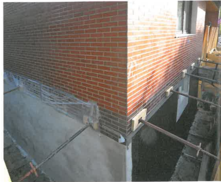
Für den Kellerausbau zur wohnlichen Nutzung mussten die Außenwände komplett getrocknet werden.
