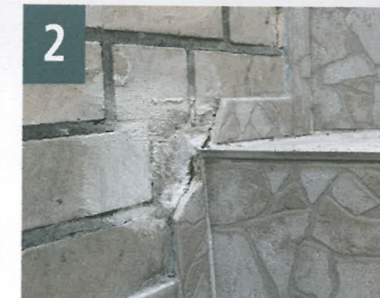
2 Im Außenbereich der Kellertreppe zeigten sich die Feuchteschäden sehr deutlich.
