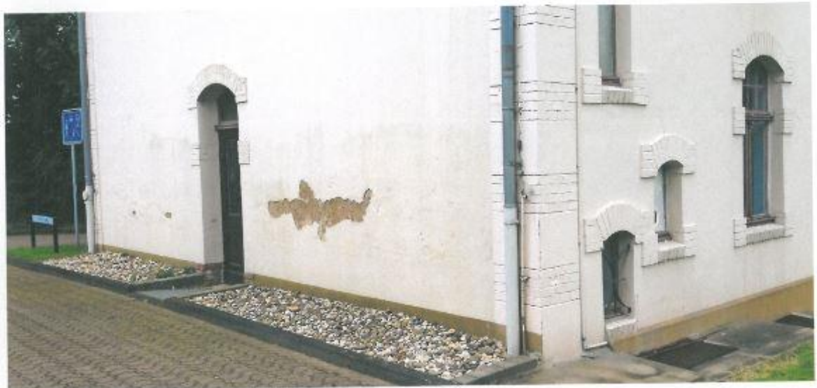
Typisches Schadensbild infolge kapillar aufsteigender Feuchte. Bilder: Isotec
